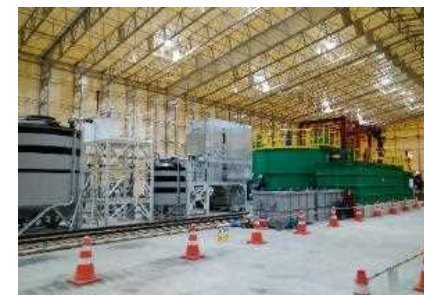
その1事業者・洗浄設備
