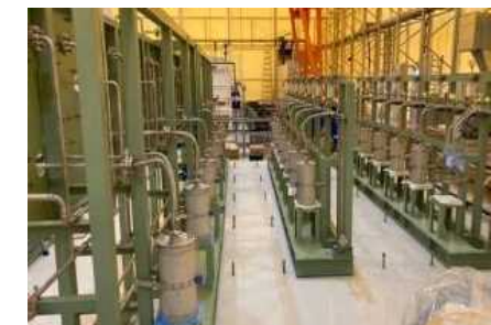
その1事業者・吸着設備
