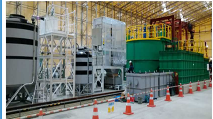
洗浄工程設備
