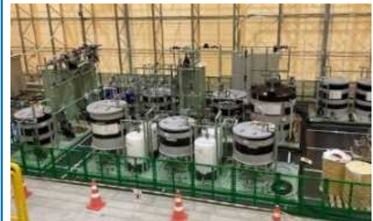
吸着工程設備
