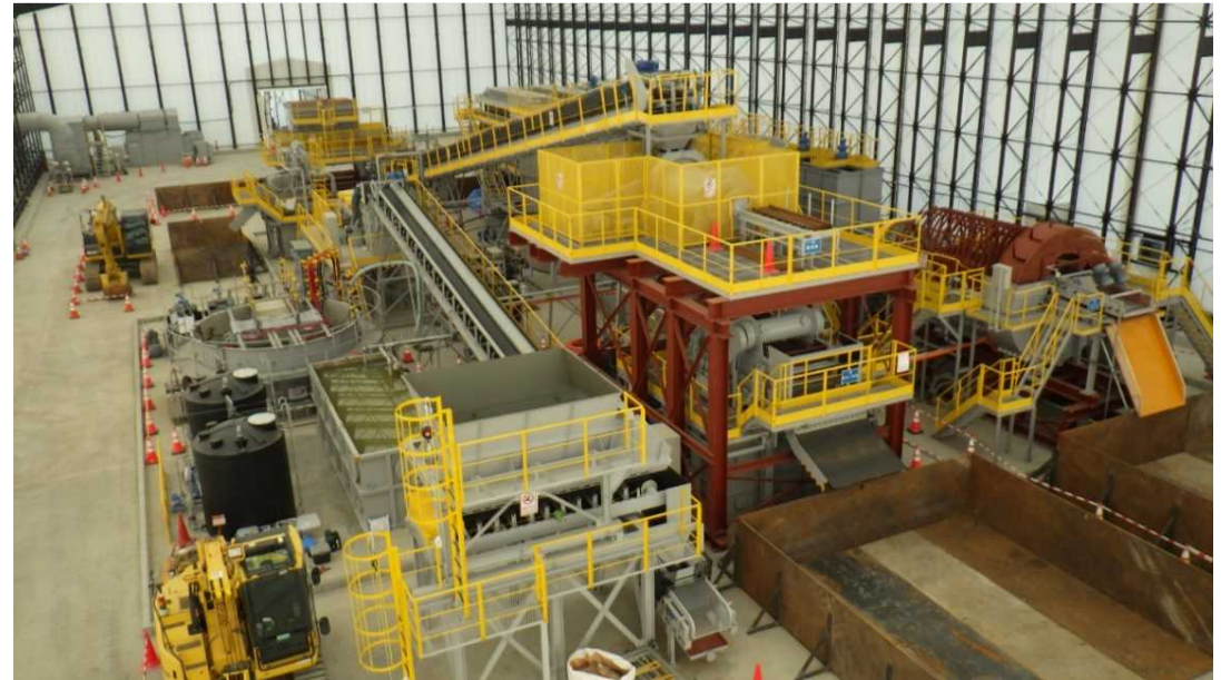
<実証設備全景>
