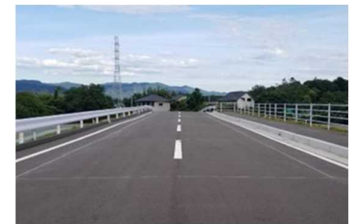
【①総重量約10t走行後】
