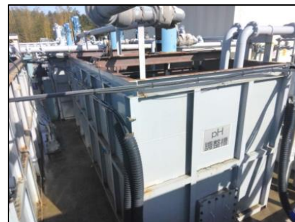
【PH調整槽外観】
