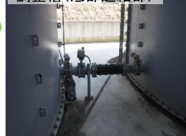
調整槽（底部連結部）
