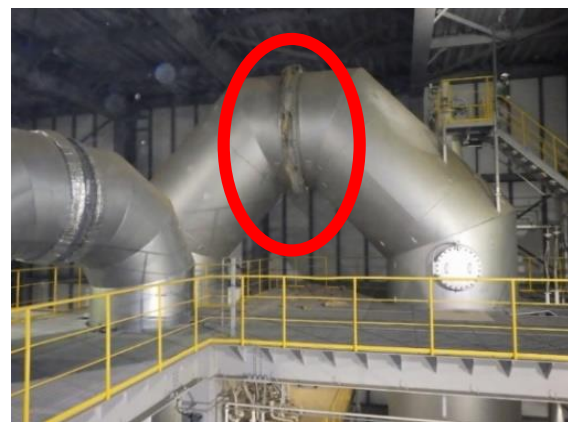
伸縮継手の損傷 （仮設焼却施設その1）
